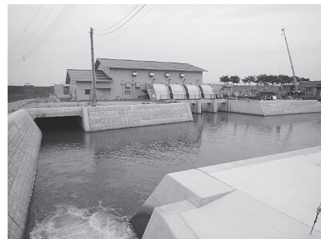
写真11 毒蛇排水機場（改修後）
