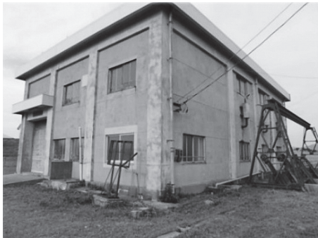
写真9 老朽化した排水機場建屋 (旧毒蛇排水機場)
