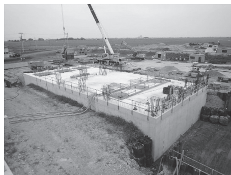
写真 15 大和排水機場吸水槽
