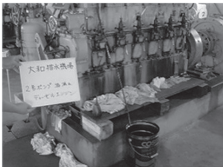
写真10 排水機場エンジンの油漏れ (旧大和排水機場)
